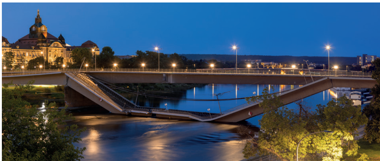
Die eingestürzte Carolabrücke in Dresden – Sinnbild des Niedergangs deutscher Verkehrsinfrastruktur
