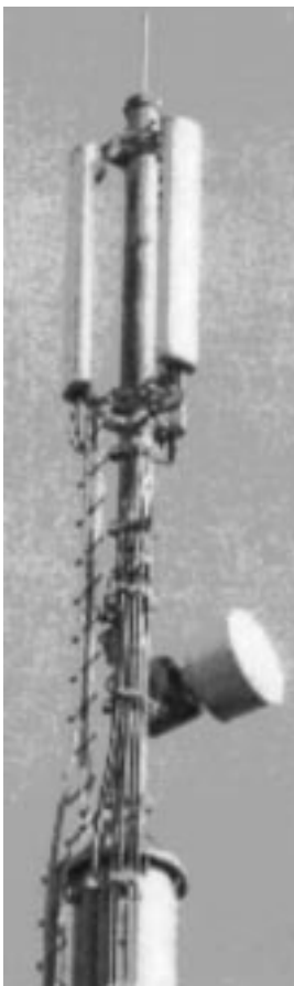
Abb. 6: An einem Gebäude montierte Funkantenne
