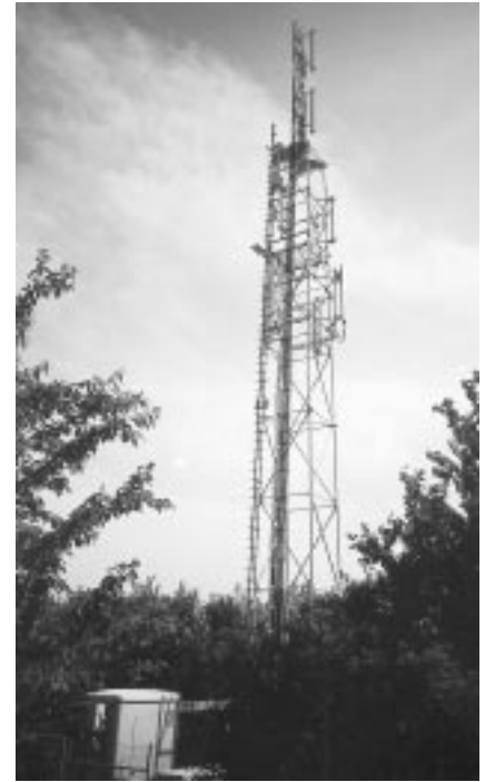
Abb. 4: Mobilfunkanlage besteht aus einer oder mehreren Antennen unterschiedlicher Gestaltung und Höhe sowie einer Versorgungseinheit
