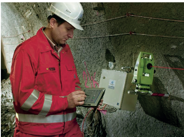
Abb. 16 | Richtlaser und Motorlasersystem zur Steuerung konventioneller Vortriebe /Geodata/
