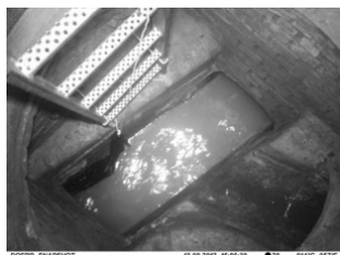
Abb. 1: Sessil®-Streifen in einem Abwasserkanal
