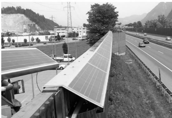
Abb. 1: PV-Anlage bei Jenbach in Tirol mit einer Nennleistung von 5 kWp und einer Länge von ca. 107 m (SED o. J., 5)
