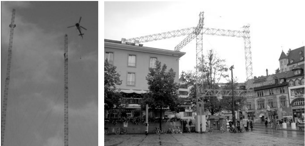
Abb. 3+4: Bauprofil-Erstellung beim Prime Tower Zürich mit Helikopter (MARGADANT 2007) und fertig installiertes Bauprofil beim Stadt Casino Basel (KNECHTLI 2006)
