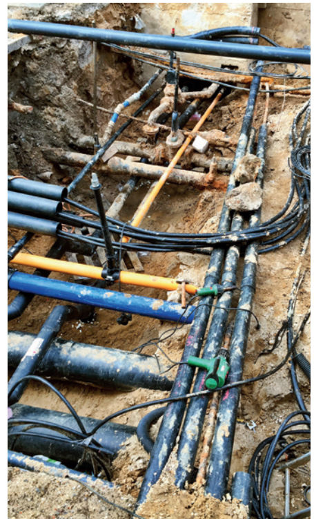
Die Kenntnis zu den genauen Leitungsverläufen ist für die Planung und Durchführung von Tiefbauarbeiten sehr wichtig
